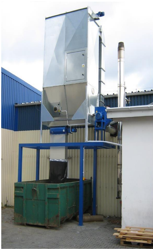
Filtračná jednotka exteriérová s výpadom do kontajnera
